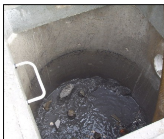
Puits de relevage
